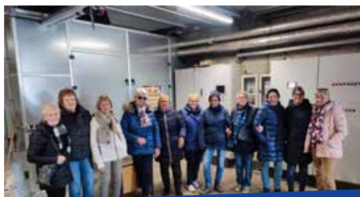
Die Damen der Radwander-Abtl., während der Besichtigung in einem Bunker – wo das installierte Blockheizkraftwerk – Wärme liefert für eine benachbarte Trocknungs-Anlage. Hier können bis zu 6000 t landwirtschaftliche Produkte getrocknet werden!
